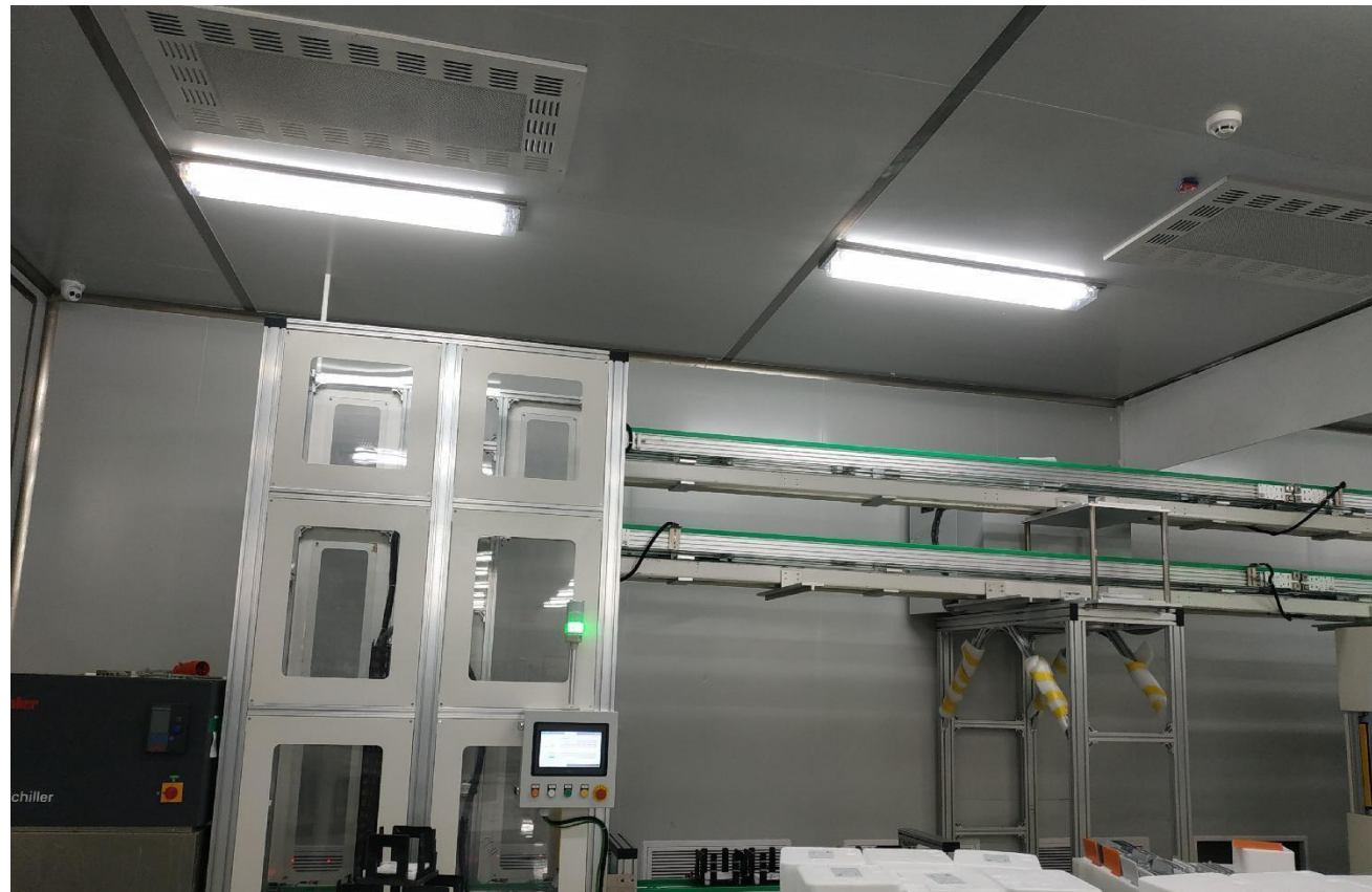
浙江晶科新能源片盒输送线项目
